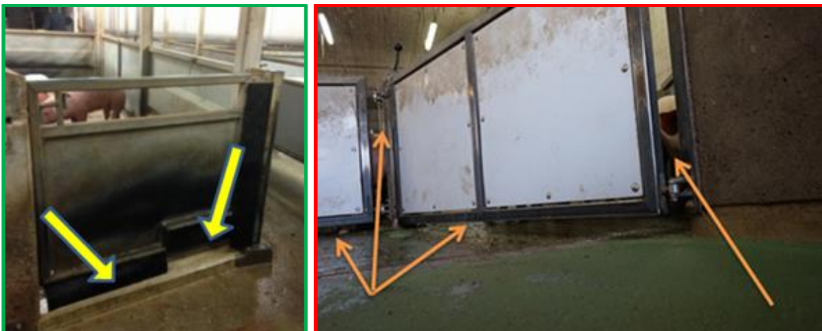
Links: Tochtsnorren bij Westfort, Rechts: tocht ruimtes onder de schotten maken varkens onrustig.
