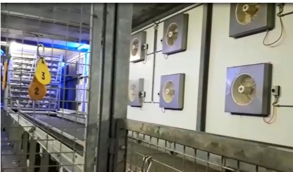
Vaste ventilatoren in de zijwanden bij de aanvoer @Storteboom
